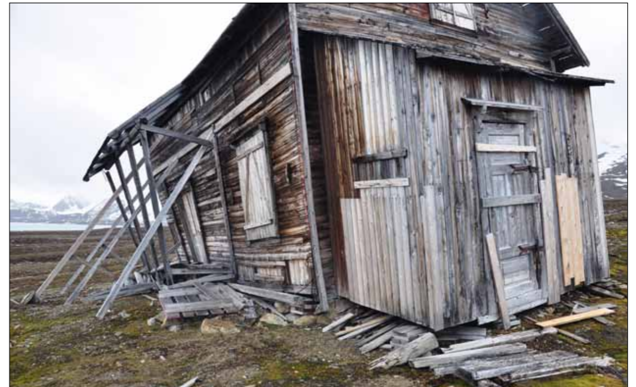
Giæverhuset i Recherchefjorden er ett av de høyt prioriterte kulturminnene på Svalbard. Hytta er bygget på svært fuktig grunn, og den vil derfor ha begrenset varighet. Sysselmannens håndverkere har stropet bygningen sammen og støttet den opp for å motvirke forfallet.
