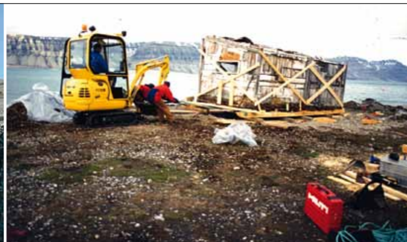
"På hjul". Gammelhytta ble løftet opp og satt på en slags slede. Den står i dag klar for eventuell ny flytting.
