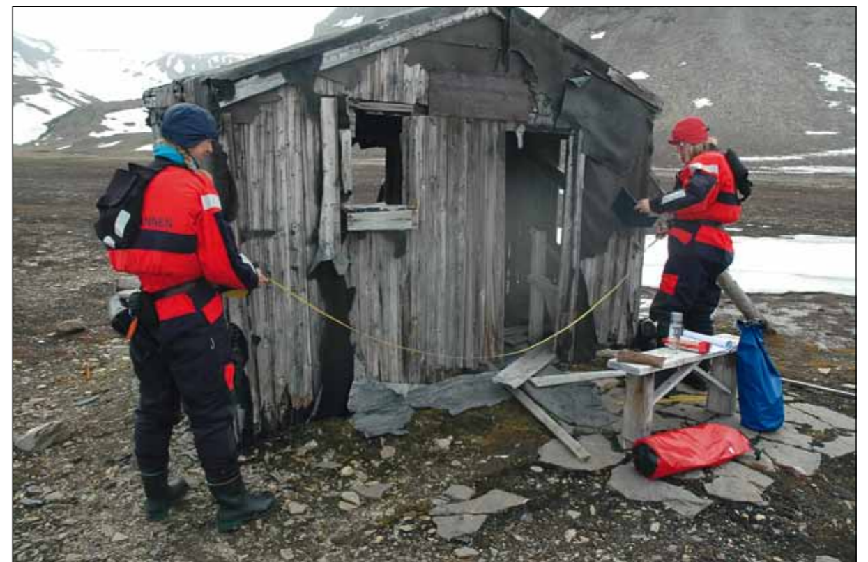
Dokumentasjon er en sentral del av Sysselmannens kulturminnearbeid. Her fra oppmåling av skader på hytta Copper Camp i St. Jonsfjorden i 2011. I bildet Hilde Tokle Yri assistert av Elin Lien (til venstre).
