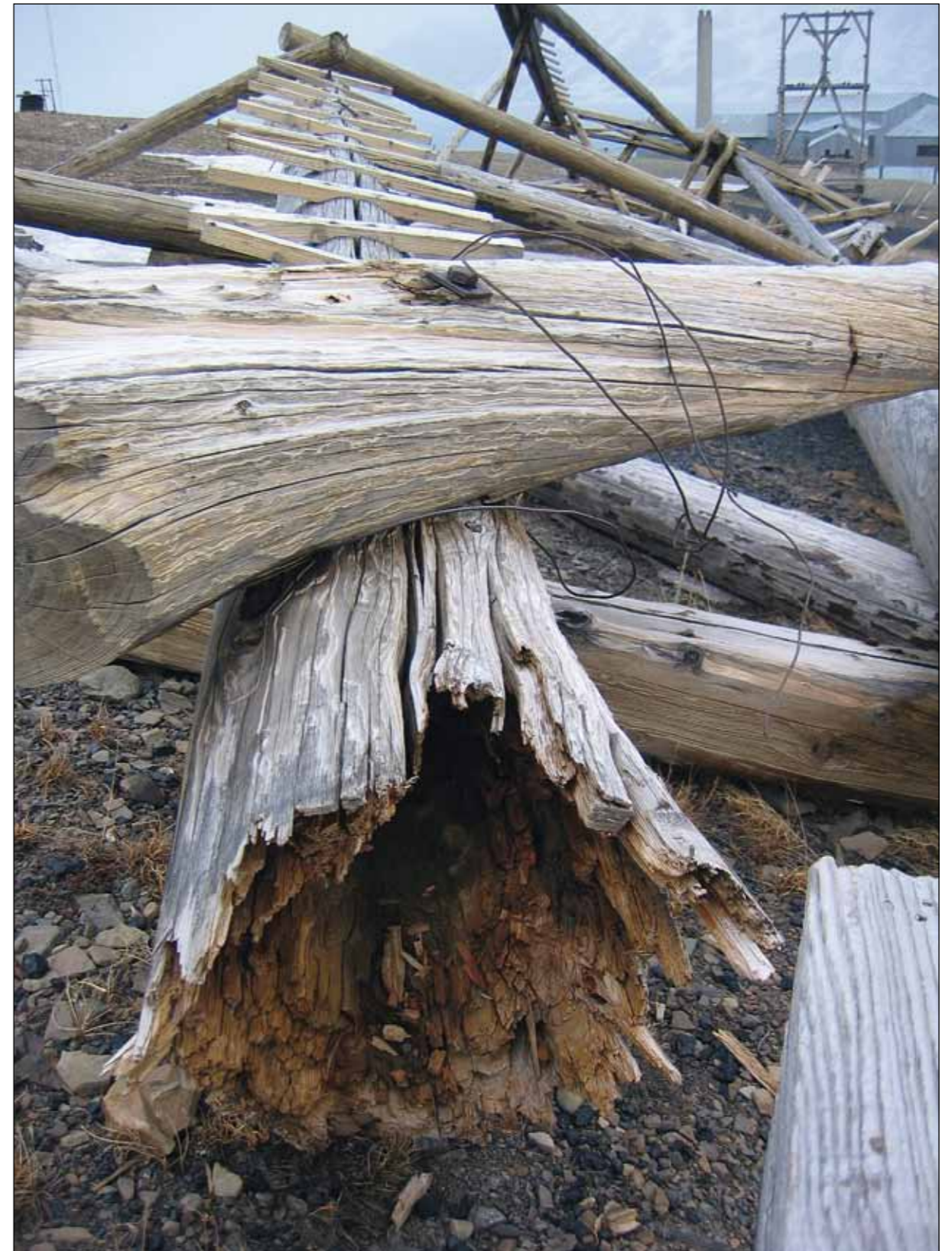
Taubanebukkene i Longyearbyen er en viktig del av byens gruvehistorie og bybildet med høy verneverdi. Mange av disse er i ferd med å råtne. Her fra en nedrast taubanebukk (nr. 23), taubanelinje 1b. Som bildet viser, var den svært råttent innvendig.
