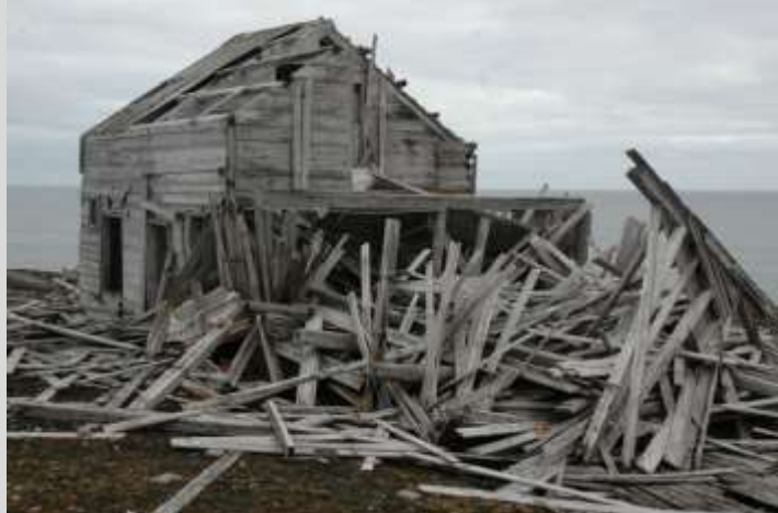
Figur 179 Bygningene på Tunheim er i dårlig forfatning. Foto: Halvard Pedersen, SMS 2011.
