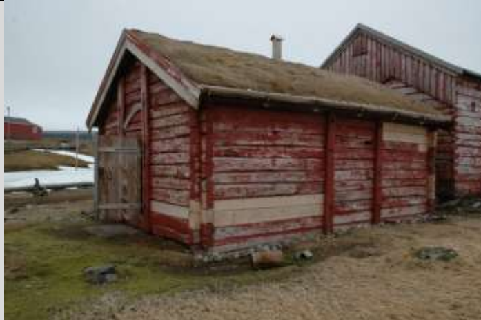
Figur 182 Hammerfesthuset til venstre. Rester av Tobiesenhuset er bevart til høyre. Viser stokker som ble skiftet ut i 2010. Foto: Irene Skauen Sandodden, 2011.
