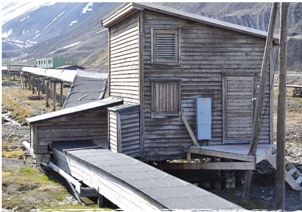
Pumpestasjon og rørkasser ved Nybyen.
