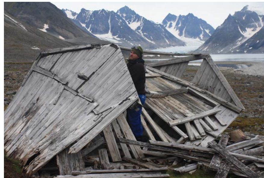
Hytten ved Magdalenefjord er rast sammen. Jakob Surlykke Fink er i ferd å dokumentere byggetekniske detaljer. Privat bilde J. Bohlmann
